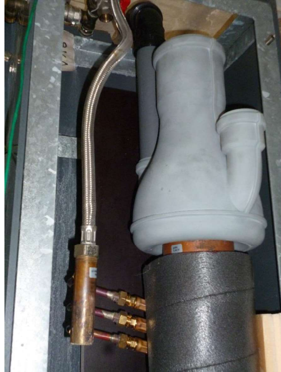
Connexion de la sortie de l'eau préchauffée
